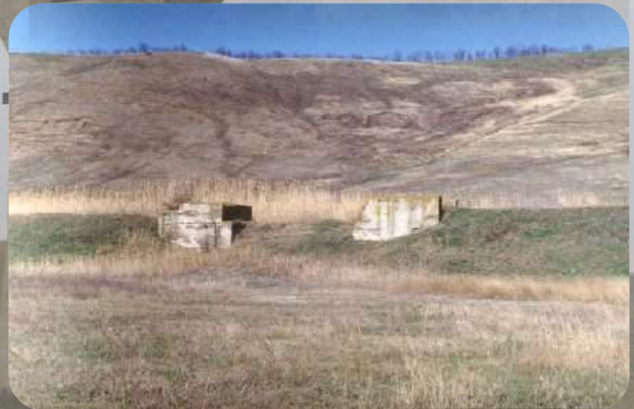
Разрушенный мост в районе х. Державный.
